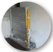
Installatie tegen de zijwand voor minimale ruimtevereisten.
